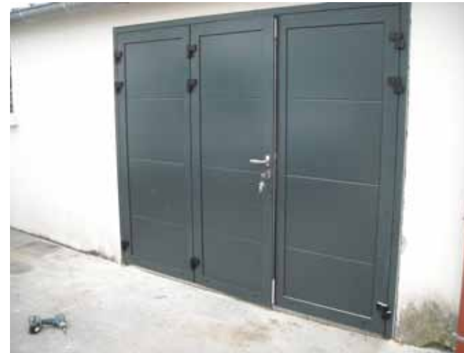
Les nouvelles huisseries de bâtiments municipaux
